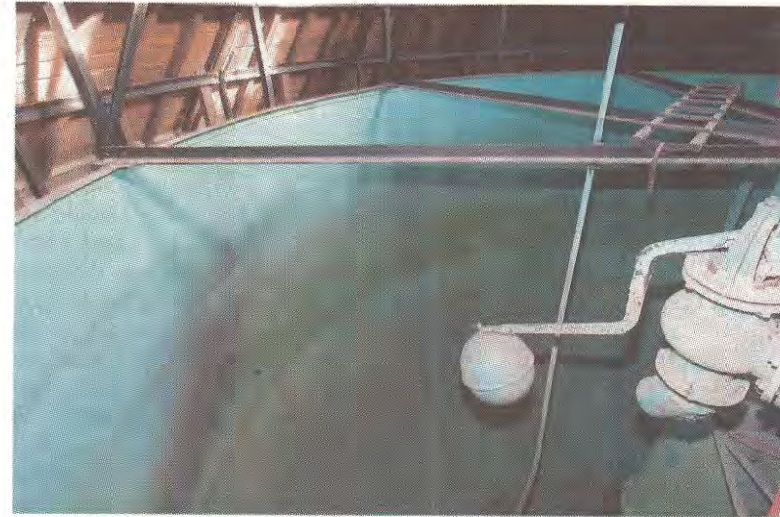
Der Wasserbehälter: Ein Schwimmer verbindet, dass er überfließ
